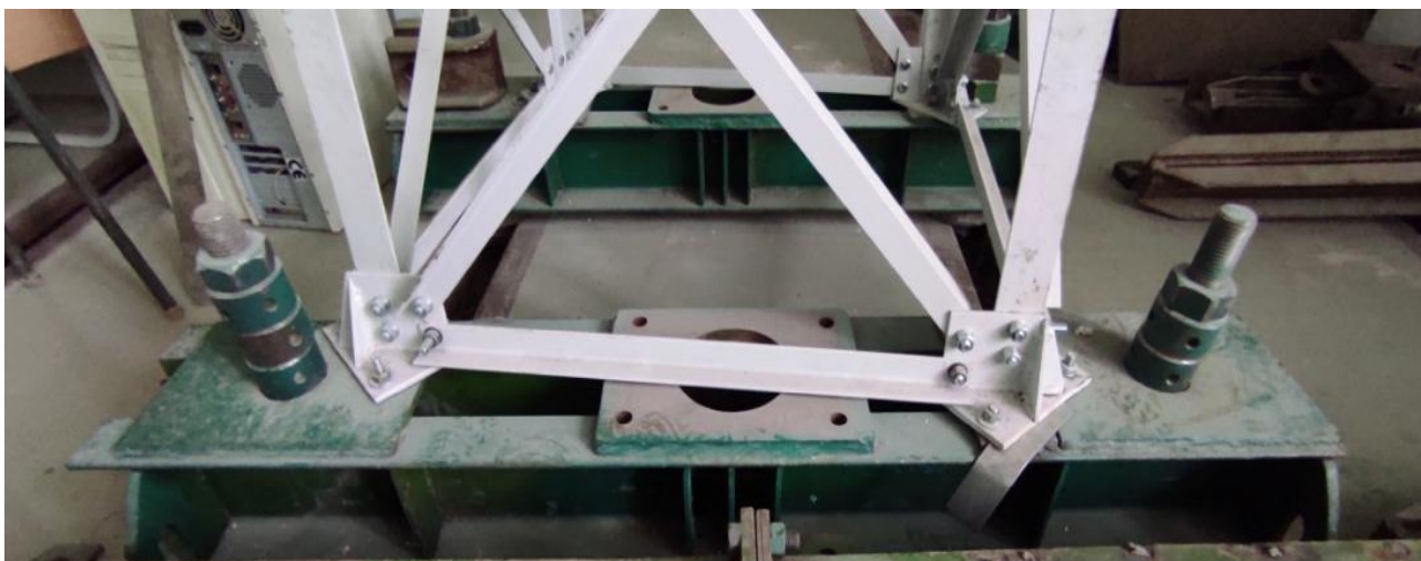
Рис. 1. Платформа экспериментальной опоры ЛЭП
